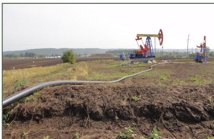
Рис.1. Транспортировка нефтепродуктов с помощью мобильной трубопроводной системы
